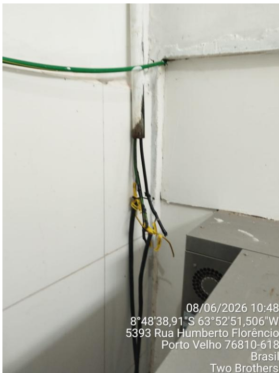
Imagem 07 – Instalações elétricas na Área de Preparo.
