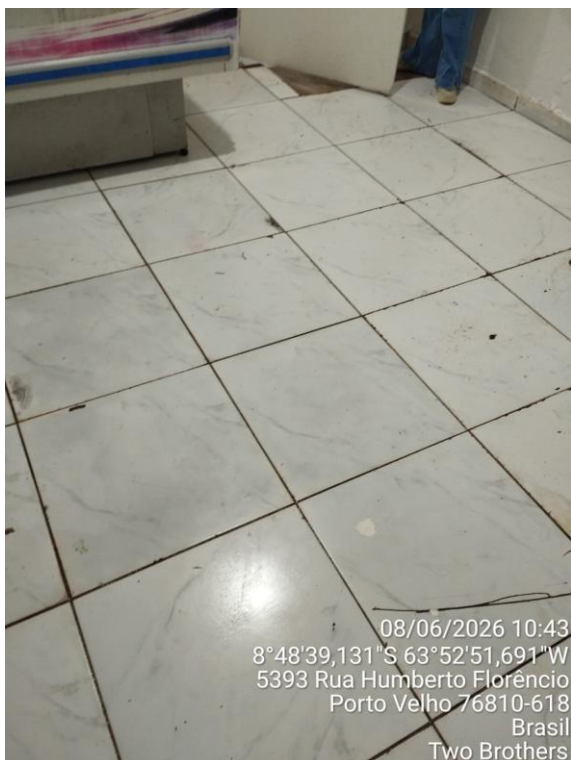
Imagens 05 e 06 – Piso da Área de Armazenamento.
