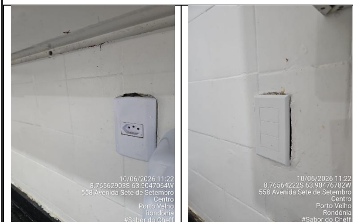
Imagens 11 e 12 – Instalações elétricas
