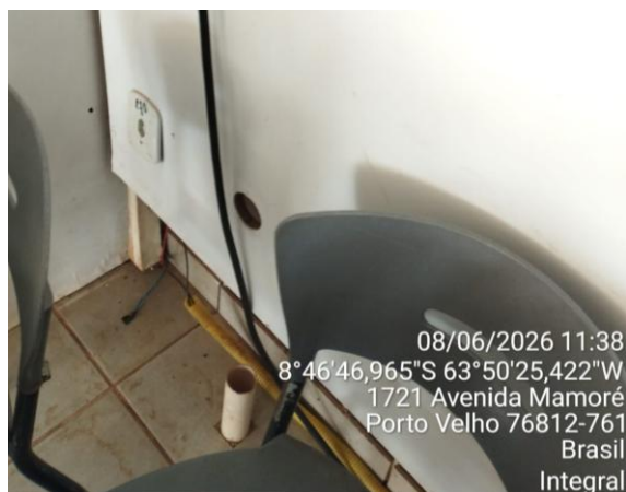
Imagens 04 a 07 – Instalações elétricas Área de Atendimento.
