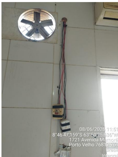
Imagem 16 – Fios Elétricos na Área de Preparo.
