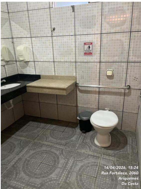
Imagem 09 – Instalação sanitária PcD.
