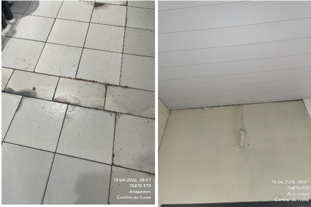
Imagens 08 e 09 – Revestimento de teto e piso com pequenas avarias.
