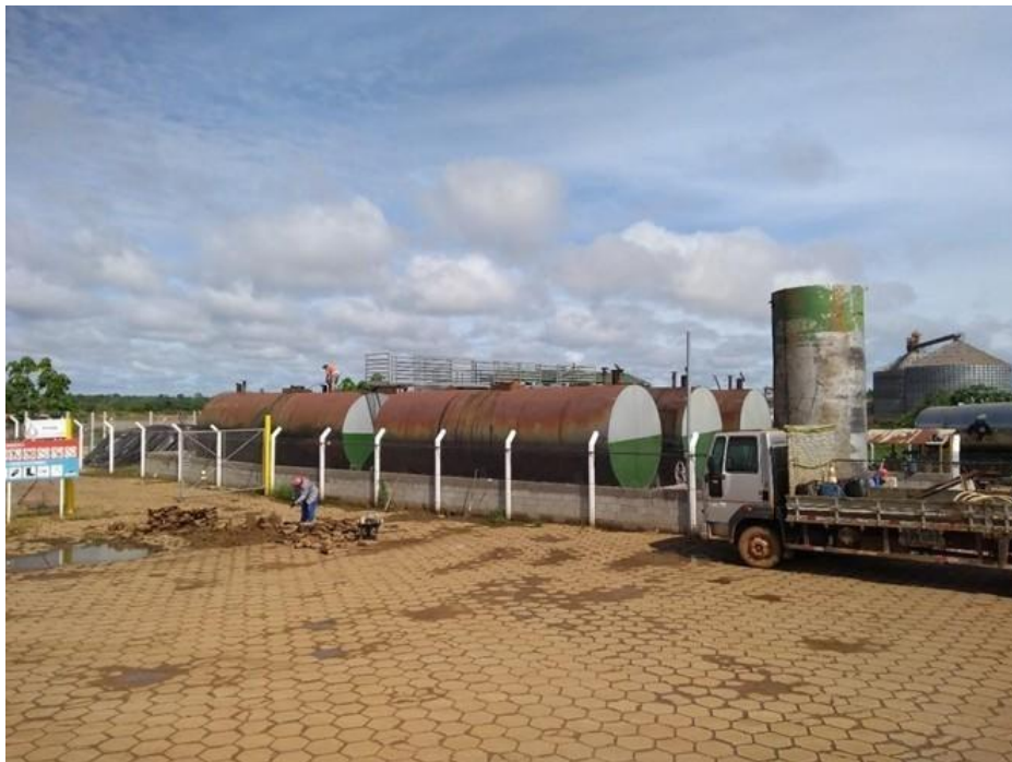
Figura 7 – Tancagem de CAP na Área das Guas
