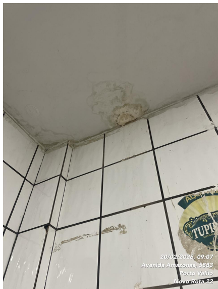
Imagem 01 - Infiltração na laje da área de atendimento.
