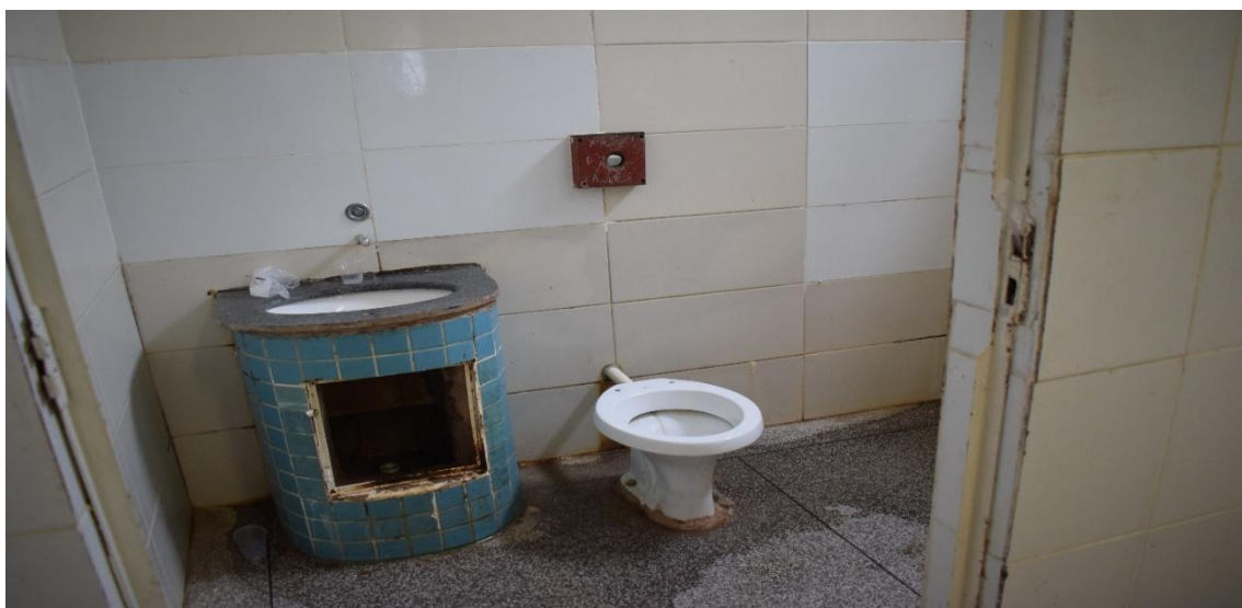
Imagem 6 - foram constatados banheiros com a estrutura precária, com vazamentos, sujos - Material fotográfico produzido pelo MEPCT/RO.
