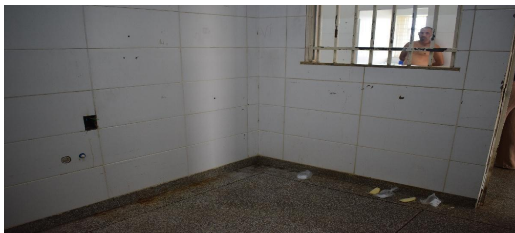
Imagem 2 - Em diversos pontos da ala masculina foram constatadas tomadas sem a devida proteção, instalações elétricas expostas. - Material fotográfico produzido pelo MEPCT/RO
