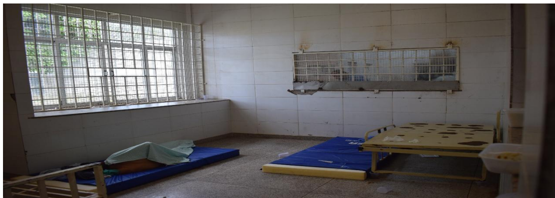
Imagem 5- Em diversos pontos da ala masculina foram constatadas internos dormindo em colchões no chão, ausência de camas, camas de ferro bastante enferrujadas - Material fotográfico produzido pelo MEPCT/RO.
