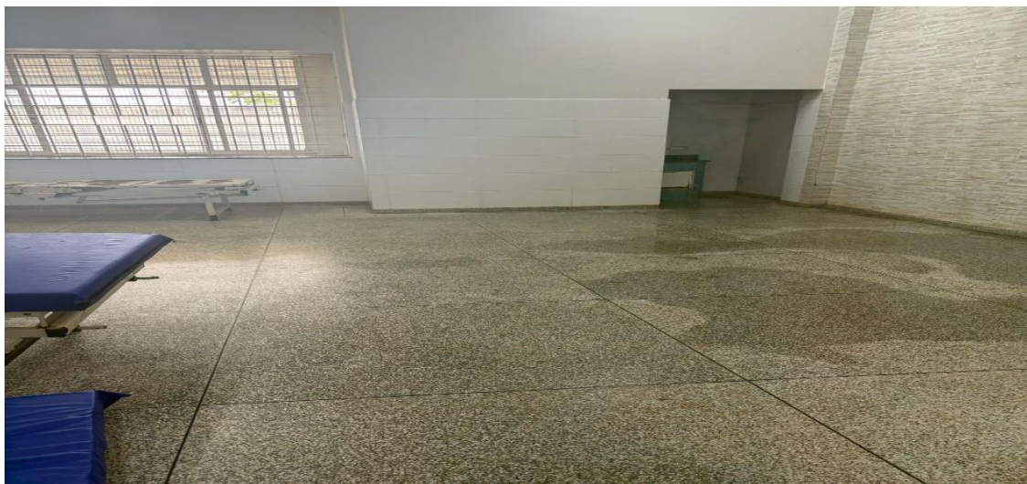
Imagem 7 - Em diversos pontos da ala masculina foram constatadas muitos colchões no chão, ausência de camas, camas de ferros bastante enferrujadas - Material fotográfico produzido pelo MEPCT/RO.
