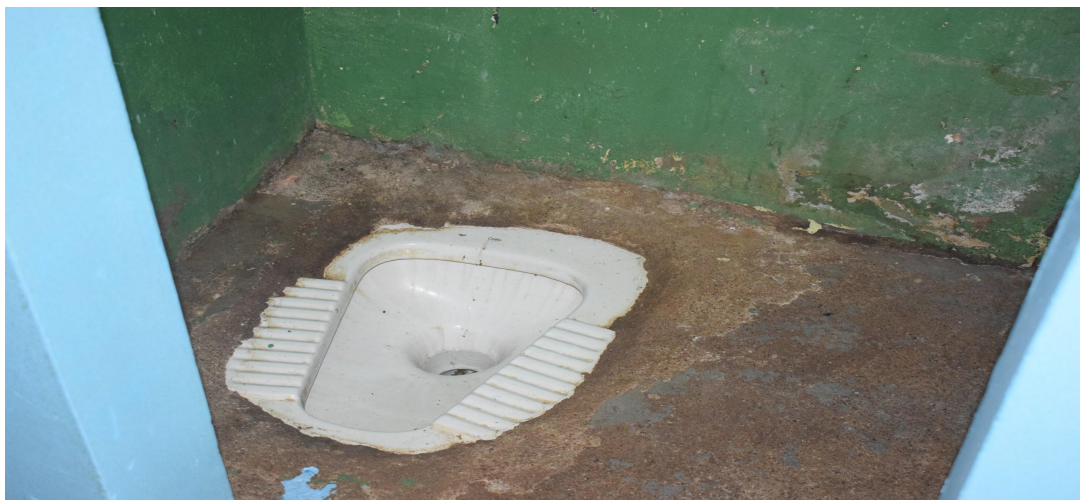
Imagem 11 - Sanitário do tipo bacia turca, com evidência de infiltrações visíveis na parede ao fundo.
