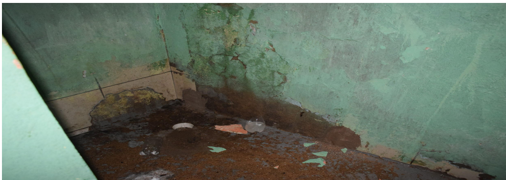
Imagem 10 - Instalação sanitária apresenta condições inadequadas, caracterizadas por elevados níveis de umidade, crescimento de mofo e presença de infiltrações nas estruturas de vedação, comprometendo a salubridade e a integridade da edificação
