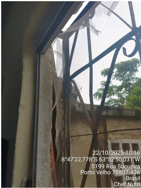
Imagem 06 - Tela da janela da cozinha mal posicionada.
