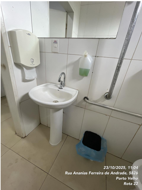
Imagem 07 - Lavatório do Banheiro PcD.
