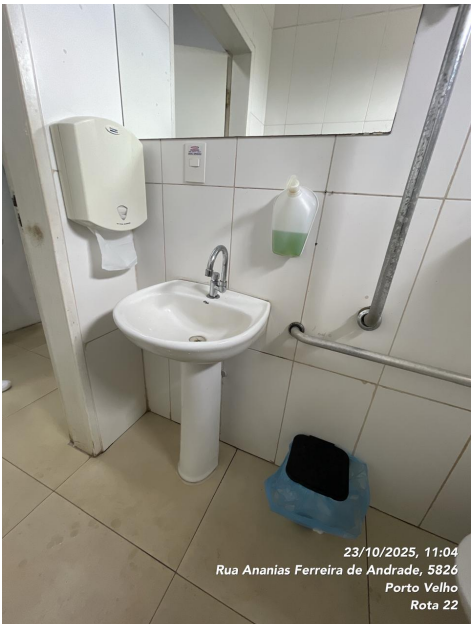
Imagem 05 - Lavatório do Banheiro PcD.
