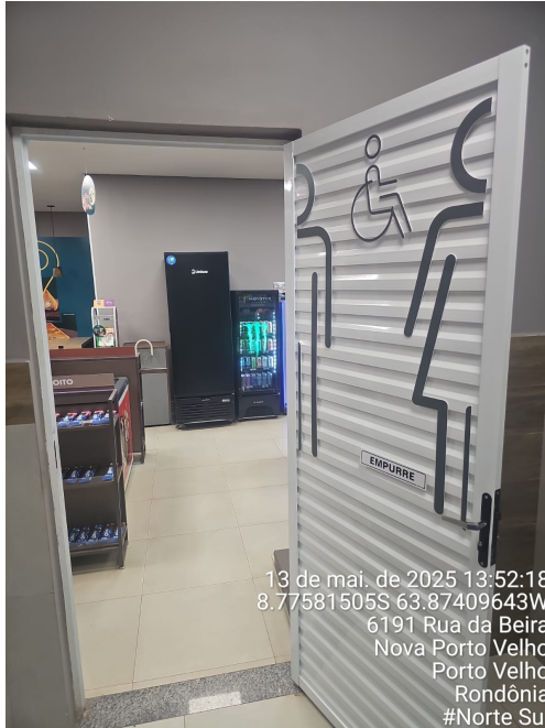
Imagem 05- Instalação sanitária PCD
