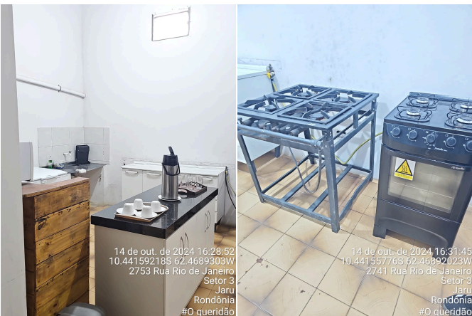
Imagens 13 e 14 - Área de Preparo sem lavatório.
