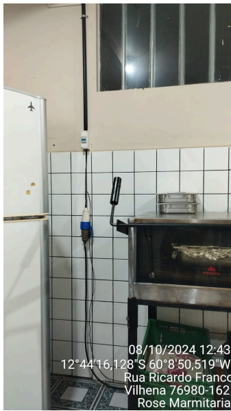
Imagem 06 - Instalações elétricas a serem ajustadas.
