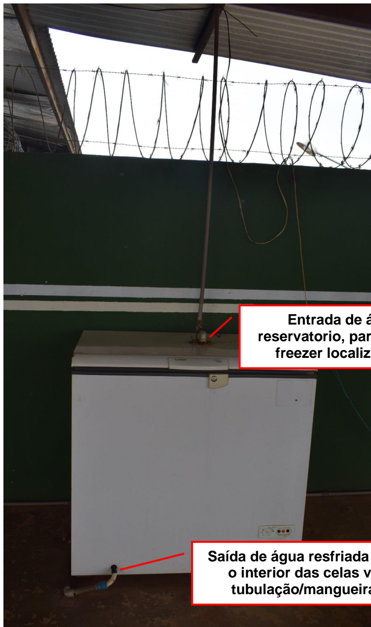
Figura 12 - Freezer instalado no terraço, fornece água potável resfriada para as celas - Foto Produzida pelo MEPCT/RO.
