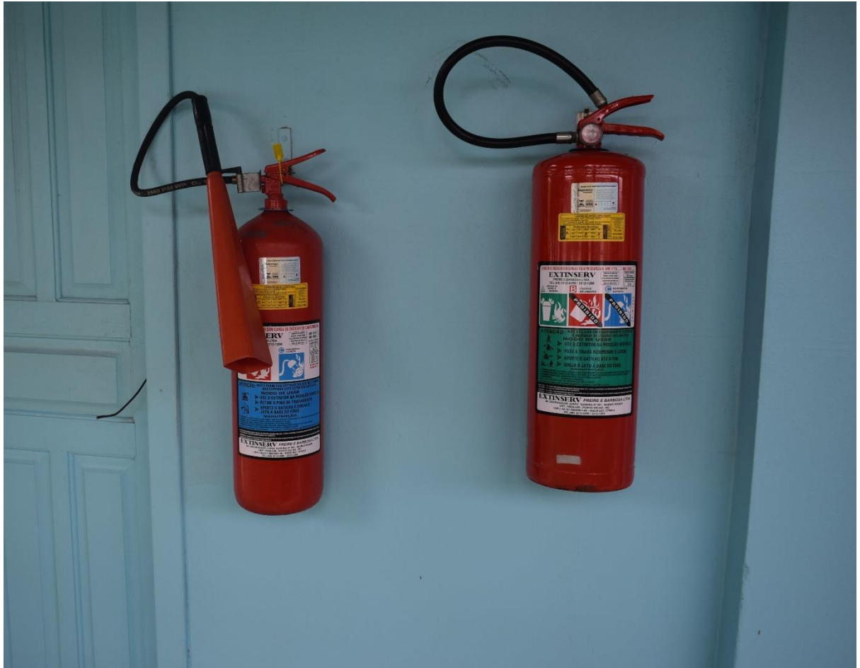
Figura 20 - Extintores expostos nas áreas comuns da Unidade, dentro dos prazos de validades. Foto produzida pelo MEPCT/RO.
