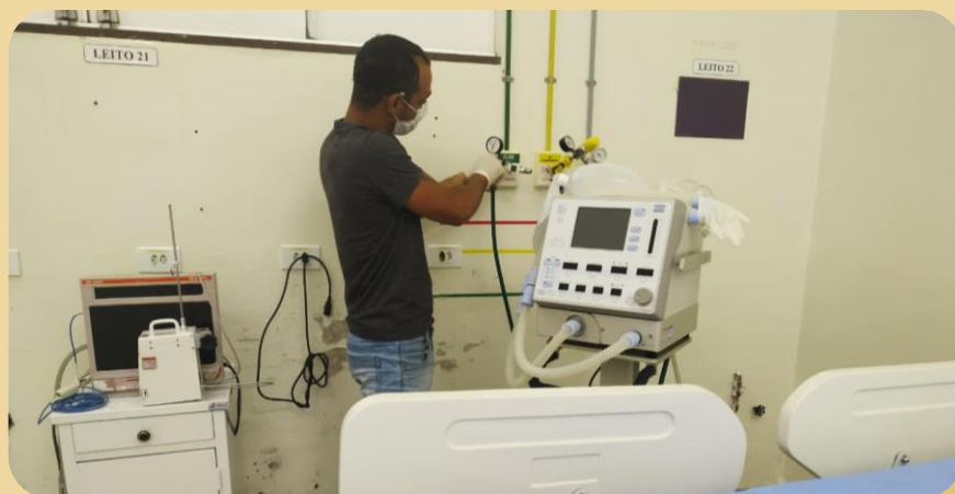
Manutenção preventiva dos gases medicinais
