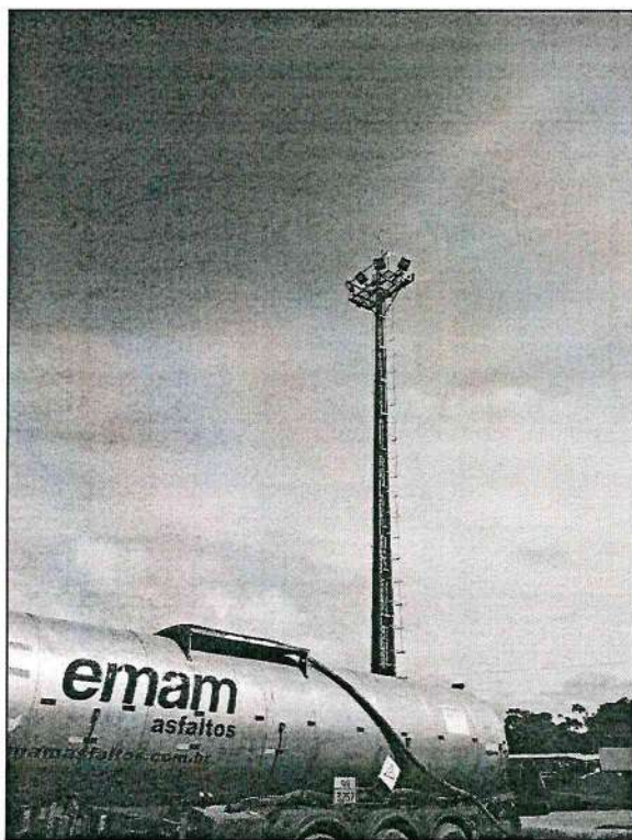
Figura 6 - Poste instalado com iluminação Led
