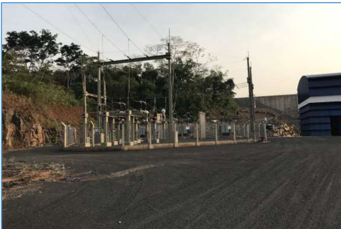
Foto 4. Subestação da Hidroelétrica Cachimbo Alto Ltda - contida no Q2.
