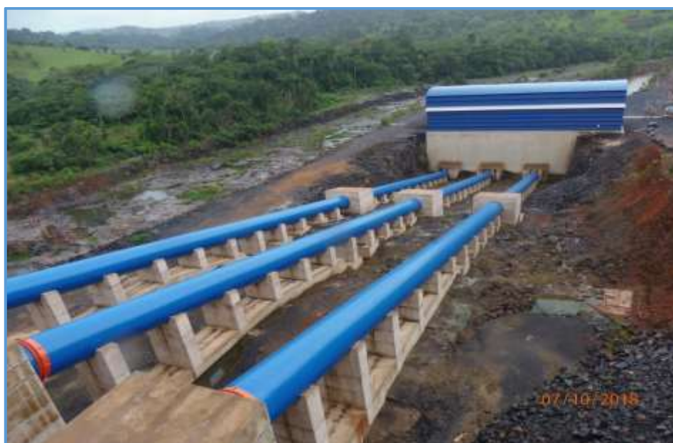
Foto 2. Infraestruturas da Hidroelétrica Cachimbo Alto Ltda no Q2 – conduto forçado, casa de força e a esquerda o leito natural do rio Branco e vegetação.
