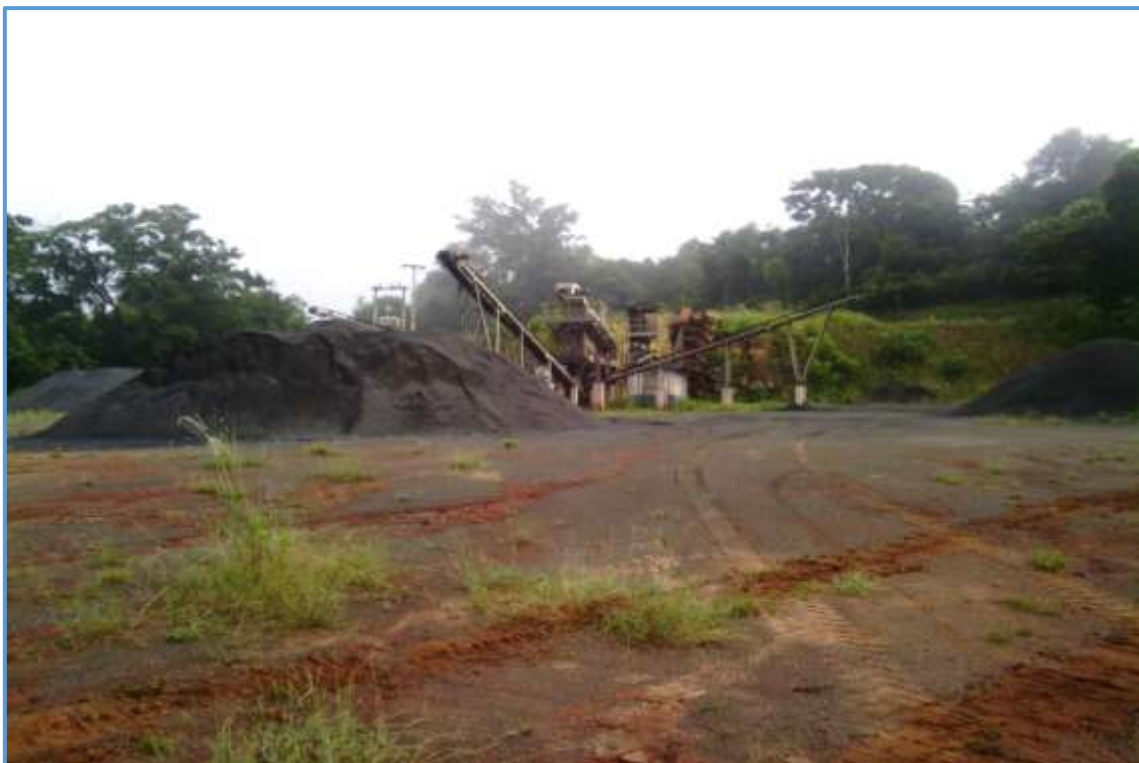
Foto 6. Área de canteiro de obras- britagem do material extraída do canal de fuga da Hidroelétrica Cachimbo Alto Ltda – contida no Q2.
